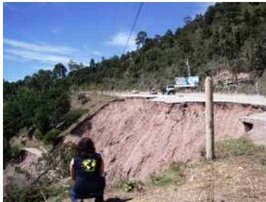
Deslizamiento en la carretera a Tegucigalpa, Honduras
