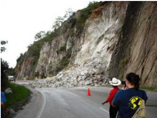
Desprendimiento en Comayagua, Honduras
